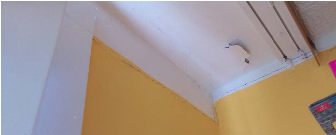
Trhliny v místě obvodového panelu
